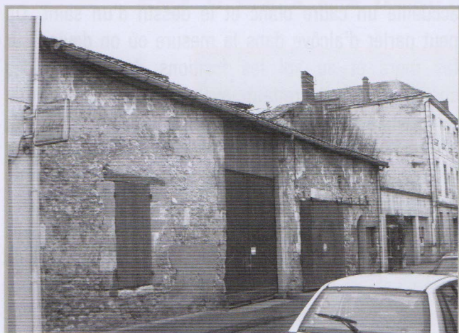
La façade nord est modifiée au XX e siècle avec l'emploi malheureux de béton.
